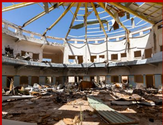
Un bâtiment de l'école détruit
